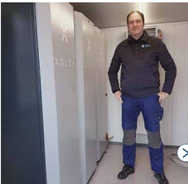
Havnefoged Frederik Bilsted Pedersen ved de store batterier i kabinen på tilsammen 240 kWh. Udefra ligner de tre store køleskabe.
